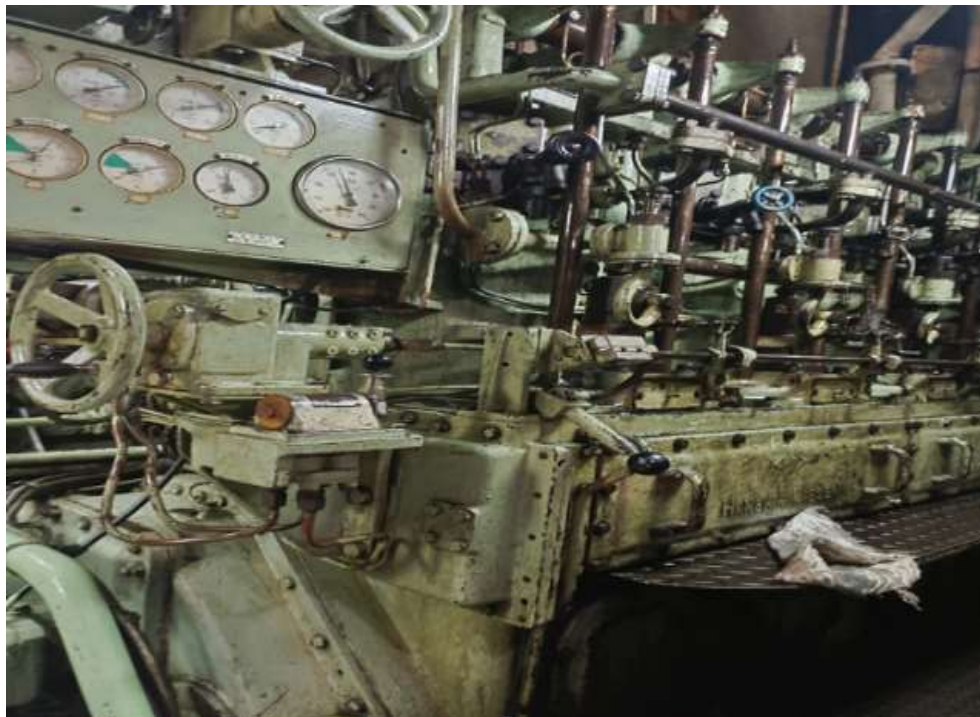
Gambar 1. Mesin Induk Kapal KM. Binama 11
