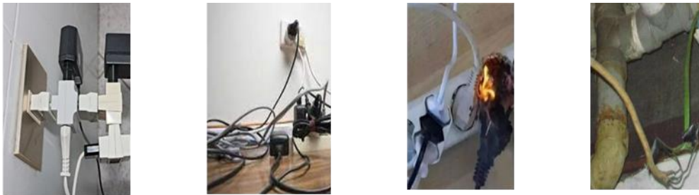
Gambar 4. Pemasangan dan penggunaan yang tidak sesuai standar PUIL
